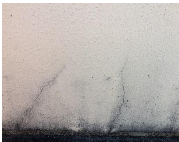
Figura 27 – Fissuras junto ao piso em paredes externas
