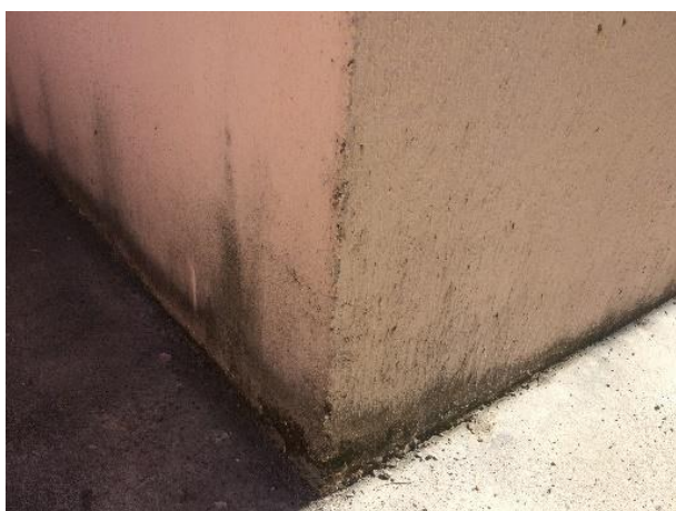
Figura 26 – Mancha de umidade junto ao piso em paredes externas
