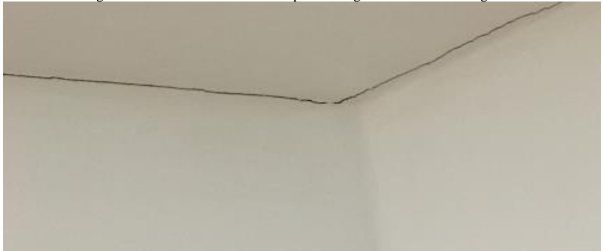
Figura 97 – Fissura no encontro da parede de gesso com o forro de gesso
