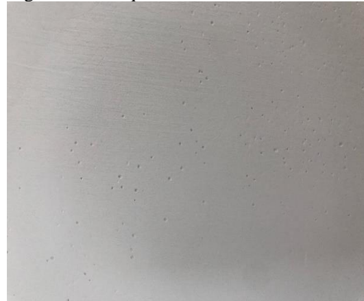
Figura 55 – Pequenos furos no revestimento
