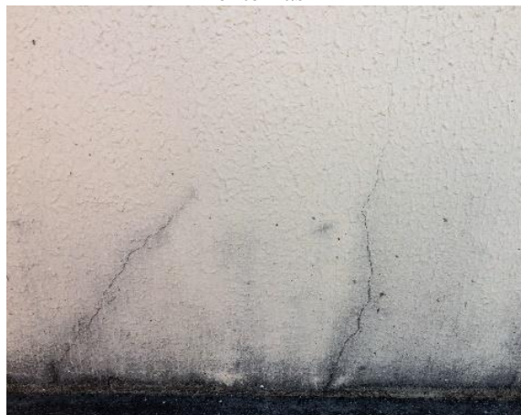
Figura 25 – Fissuras junto ao piso em paredes externas
