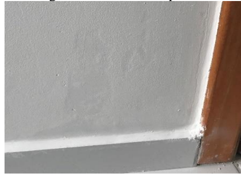
Figura 53 – Falhas da pintura
