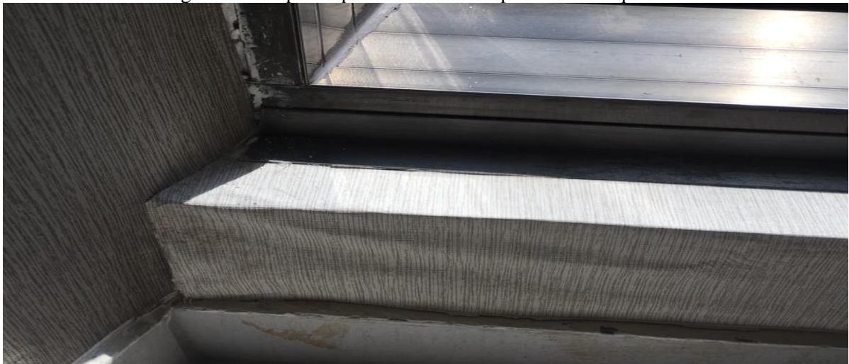
Figura 94 – Papel de parede descolando próximo as esquadrias
