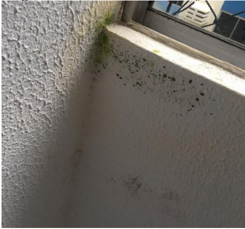
Figura 54 – Bolor ao redor das janelas
