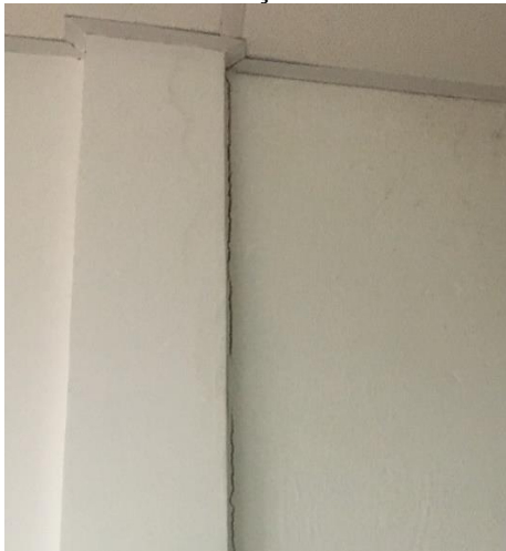
Figura 69 - Fissuras no encontro de dois tipos de vedações
