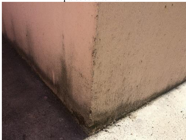
Figura 24 – Mancha de umidade junto ao piso em paredes externas
