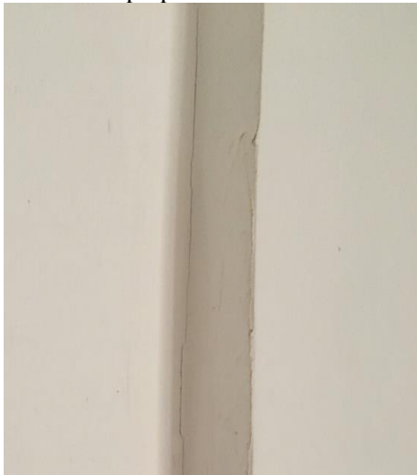
Figura 67 - Fissuras nas ligações de paredes perpendiculares
