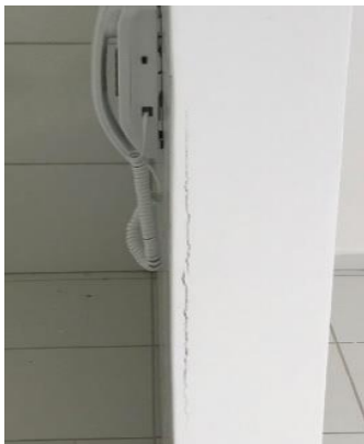
Figura 56 – Descolamento do revestimento cerâmico
