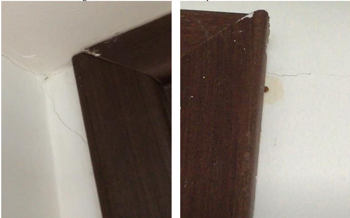
Figura 95 – Fissuras ao redor das esquadrias de madeira
