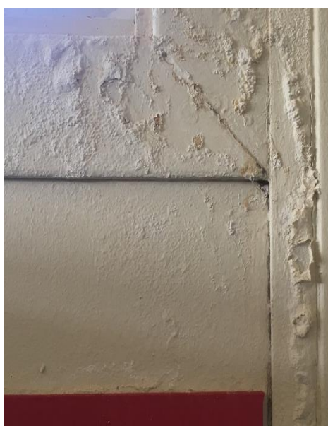
Figura 85 – Manchas e desagregação do revestimento ao redor das janelas
