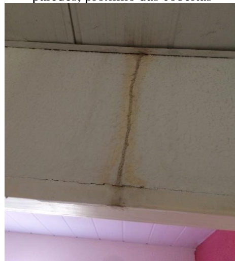
Figura 37 – Mancha de umidade no topo das paredes, próximo das cobertas
