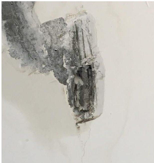
Figura 111 – Vista interna dos espaços vazios ocasionados pela presença de ancoragem
