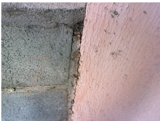
Figura 28 – Fissuras na ligação de paredes de concreto e paredes de alvenaria (bloco cerâmico ou de concreto)
