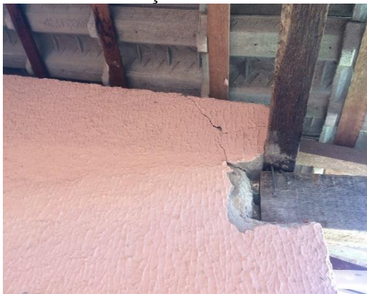
Figura 34 – Fissuras em áreas que sofreram intervenção dos usuários
