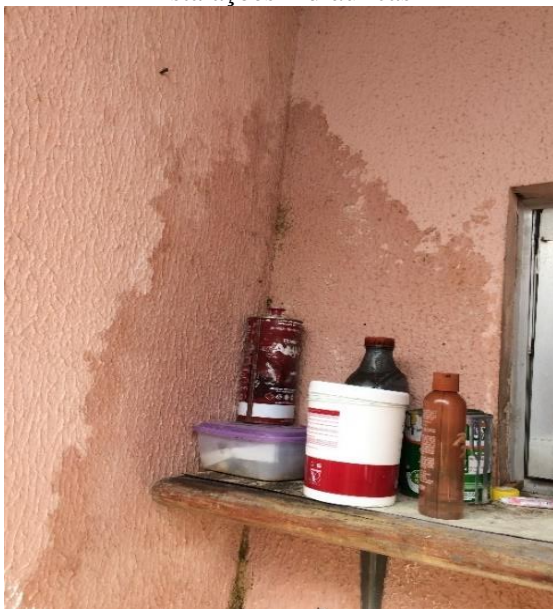
Figura 22 – Mancha de umidade em paredes com instalações hidráulicas
