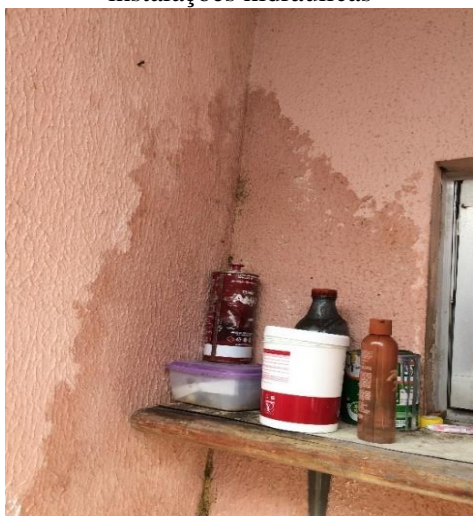
Figura 36 – Mancha de umidade em paredes com instalações hidráulicas
