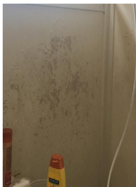
Figura 86 – Manchas e desagregação do revestimento em áreas molhadas
