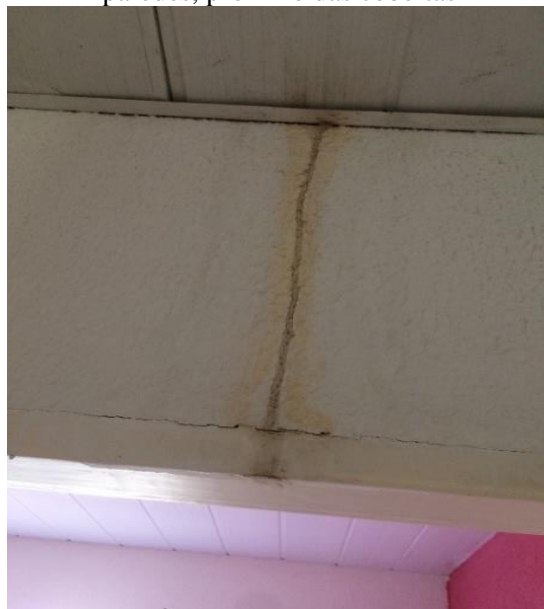
Figura 23 – Mancha de umidade no topo das paredes, próximo das cobertas
