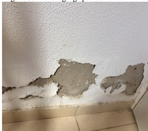
Figura 35 – Desagregação do revestimento
