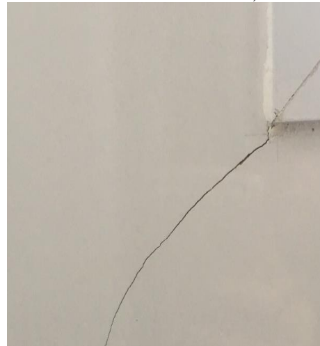
Figura 68 - Fissuras ao redor das esquadrias (de alumínio e de madeira)
