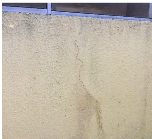
Figura 29 – Fissuras nas aberturas de portas e janelas
