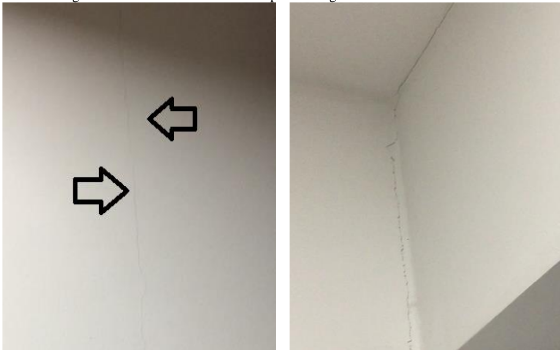
Figura 96 – Fissuras no encontro da parede de gesso com elemento estrutural
